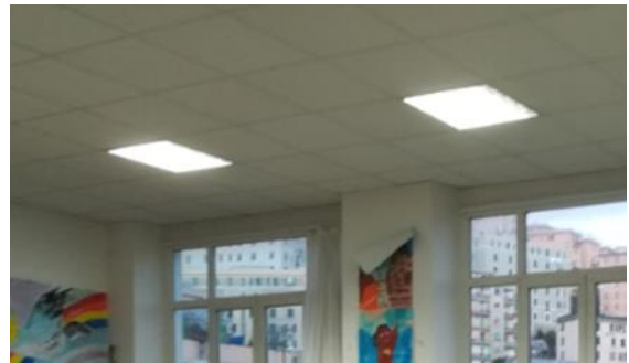
Figura 8.5 – Particolare dei corpi illuminanti
