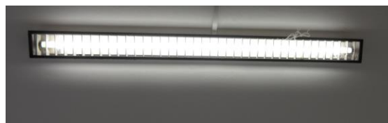
Figura 4.15 - Particolare dei corpi illuminanti ubicati nella struttura oggetto di DE
